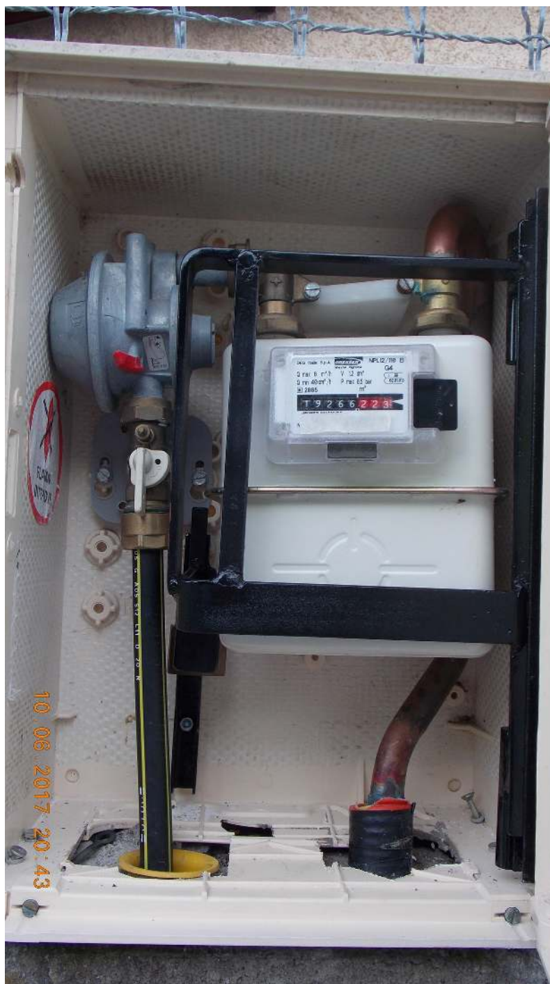
Protection d'un compteur de gaz
